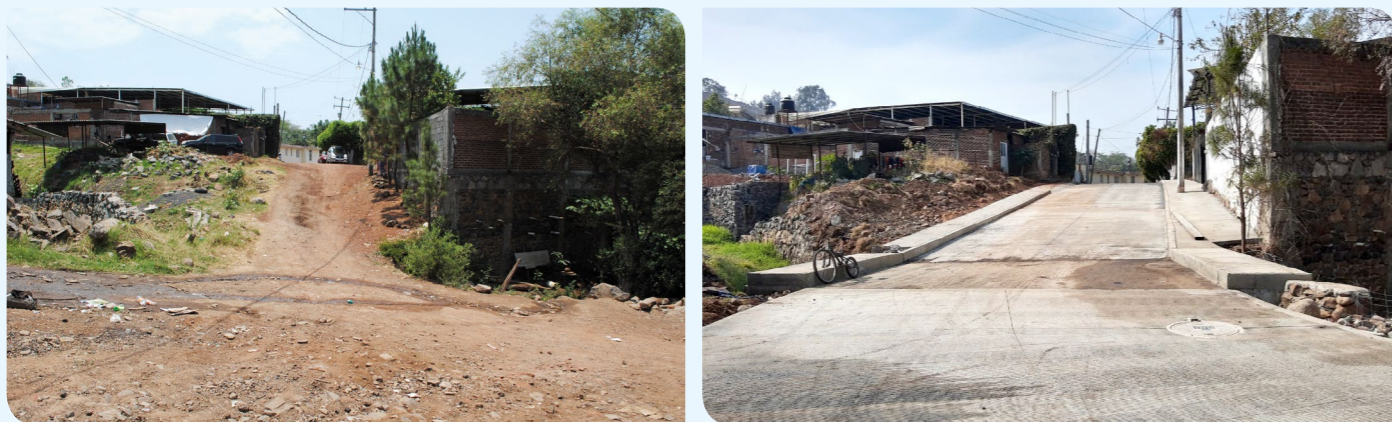
REHABILITACIÓN DE AGUA POTABLE Y RED DE ALCANTARILLADO - E. ZAPATA, FCO. I. MADERO Y 10 DE ABRIL - SAN JUAN - LOS REYES
